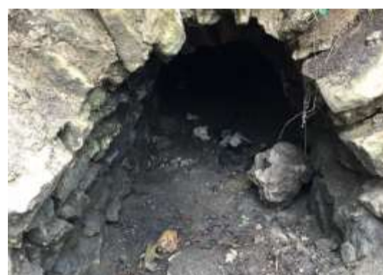
Entrée du crapauduc depuis le Parc de Rentilly emprunté par une femelle et 2 mâles crapaud commun (Source : CAMG)
